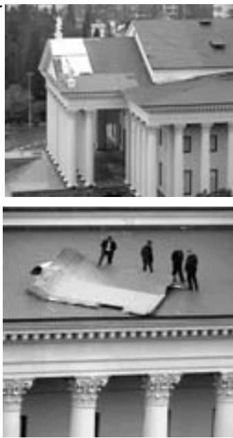
ЖИЛЫЕ ДОМА, САМЫЕ БОЛЬШИЕ ПОВРЕЖДЕНИЯ — ДО 100 КВ. МЕТРОВ КРОВЛИ — НА УЛ. ГРАНАТНОЙ, САНАТОРНОЙ, ЧЕХОВА, В МИКРОРАЙОНЕ БЫГХА. КРОМЕ ТОГО, ЕСТЬ ПОВРЕЖДЕНИЕ КРОВЛИ В РЯДЕ ШКОЛ И МУНИЦИПАЛЬНЫХ УЧРЕЖДЕНИЙ. К ВОССТАНОВИТЕЛЬНЫМ РАБОТАМ СОТРУДНИКИ РЭО И ПОДРАДНЫХ ОРГАНИЗАЦИЙ ПРИСТУПИЛИ УЖЕ В 18 ЧАСОВ СРЕДЫ. ПЛАНИРУЕТСЯ, ЧТО РАБОТЫ БУДУТ ПОЛНОСТЬЮ ЗАВЕРШЕНЫ В БЛИЖАЙШИЕ ДВА ДНЯ.
